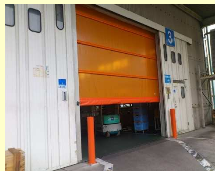
既設工場のシートシャッター
